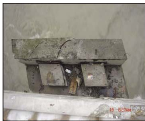
(d) Exposed bearings (at location B)
